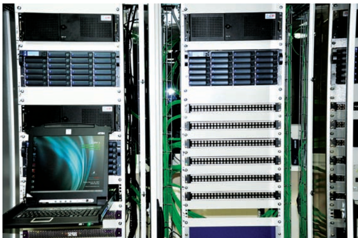
Серверная вещательного комплекса на базе SL NEO
